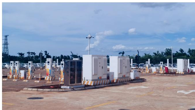
中油绿能海南公司充电站智能监控系统
